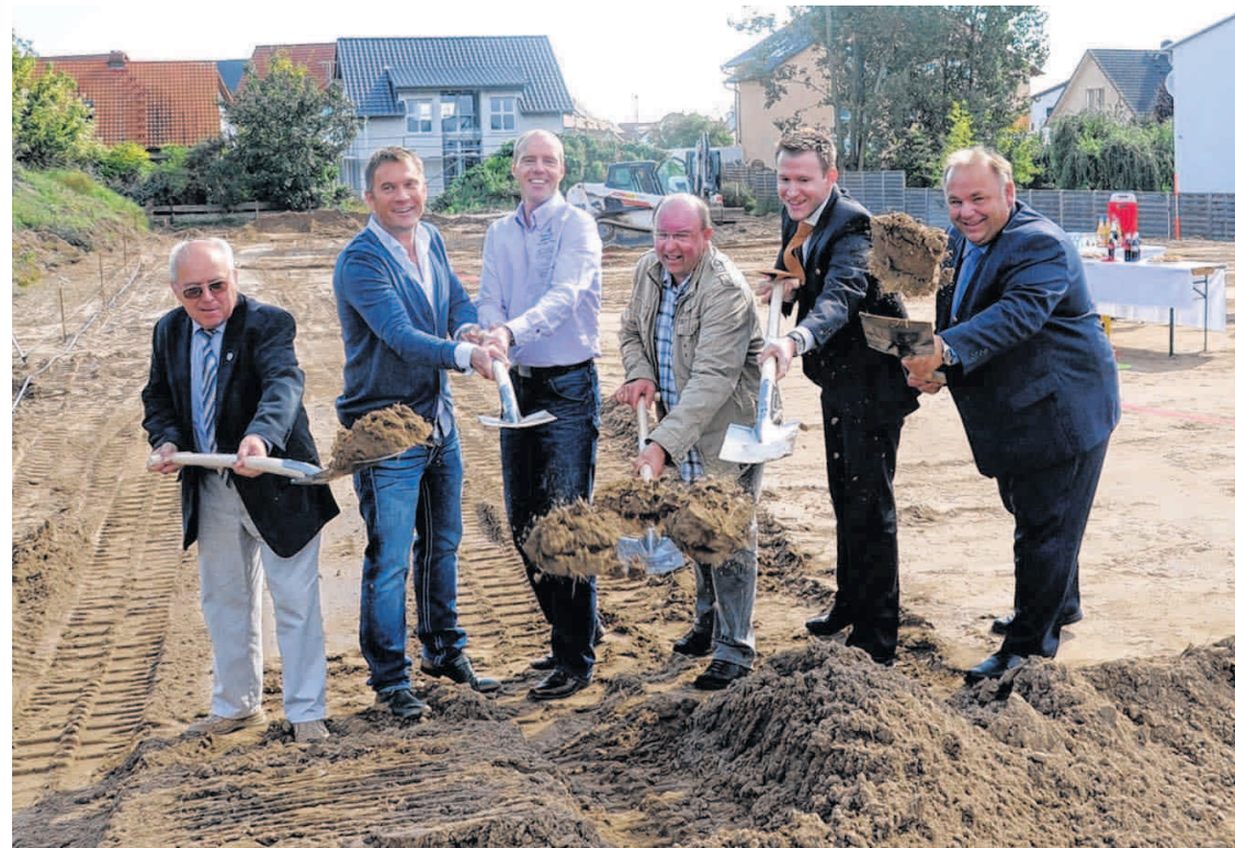
Sven Foht und Dirk Nieber (2. und 3.v.l.), Geschäftsführer der Firma Futura Fundamentsysteme, griffen gestern gemeinsam mit Bergstraße's Wirtschaftsförderern wie EGL-Geschäftsführer Volker Knaup (3.v.r.) zum Spaten. Das expandierende Energiesparunternehmen aus Norddeutschland baut in Lorsch einen zweiten Firmensitz. SCH/BILD: LOTZ
